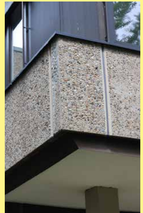
Abbildung 08: Erhaltungszustand der Decken und Außenfassaden im Jahr 2025.
